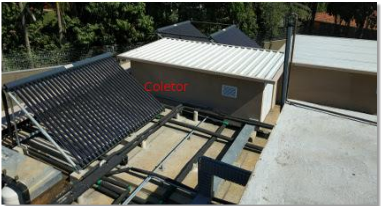
Figura 26: Local de instalação dos coletores solares tubo a vácuo
