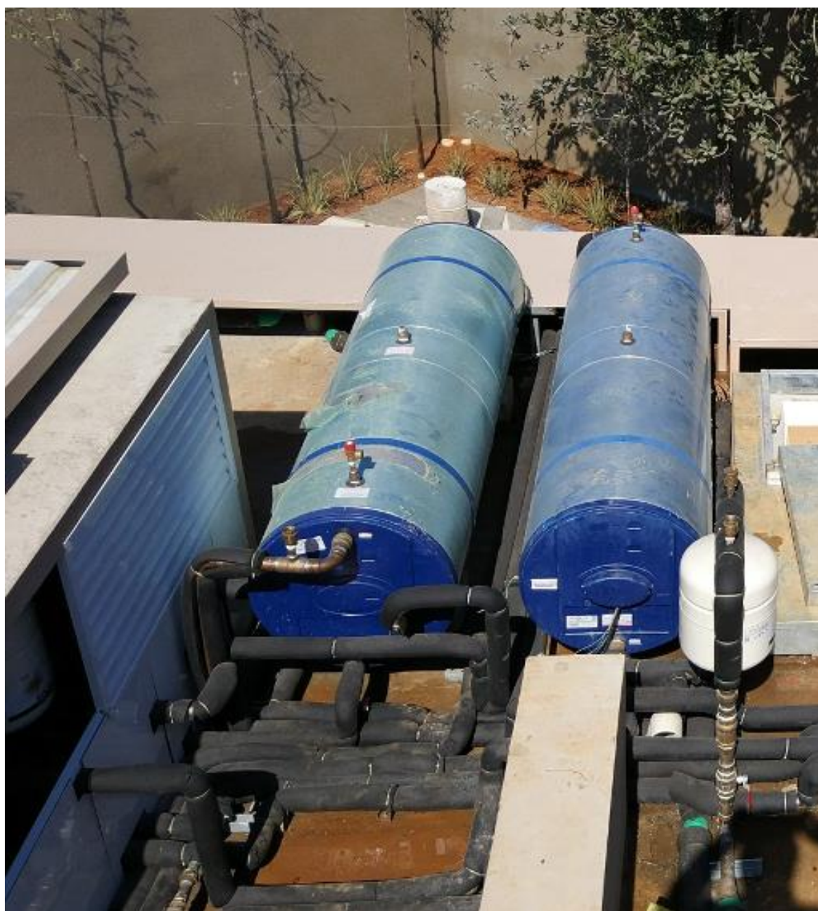
Figura 16: Reservatórios térmicos do sistema de aquecimento de banhos. Capacidade de 500 litros interligados em série. Fonte: Acervo próprio.
