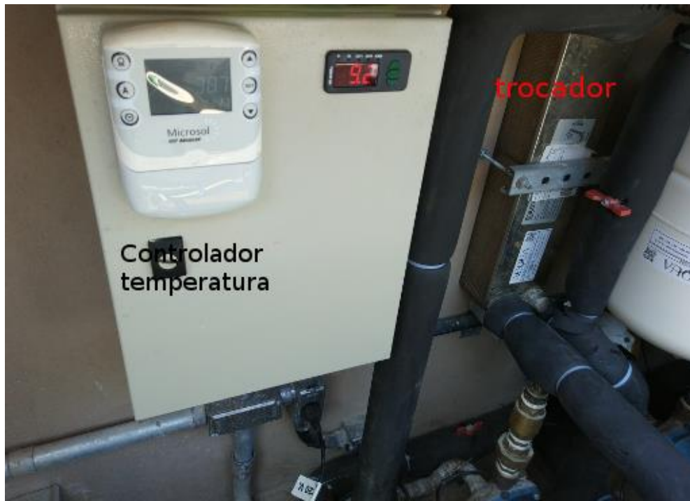
Figura 29: Trocador de calor de placas e painel controlador de temperatura do sistema solar e gás.
