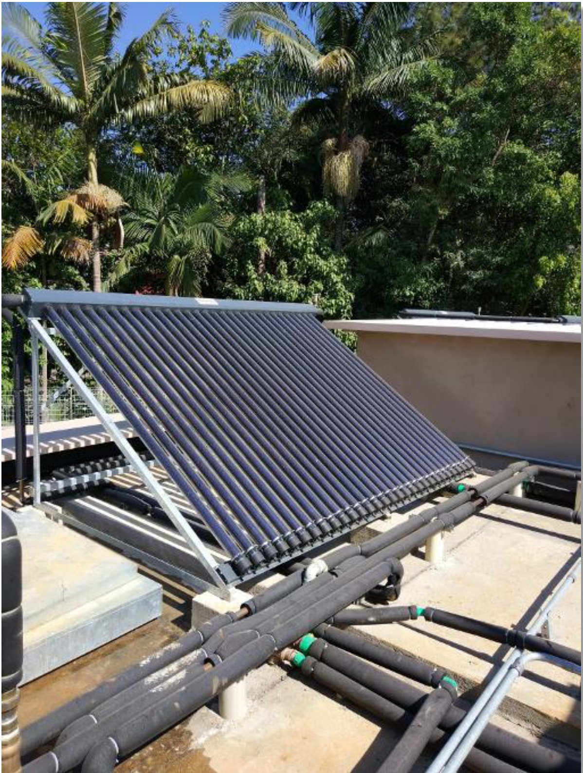
Figura 17: Coletor tubo a vácuo. Fonte: Acervo próprio.
