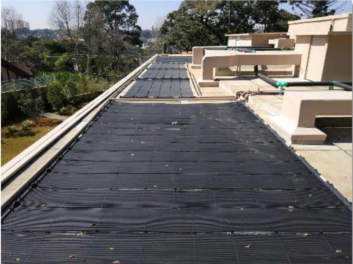
Figura 15: Coletores solares planos abertos utilizados para o aquecimento da piscina. Fonte: Acervo próprio.
