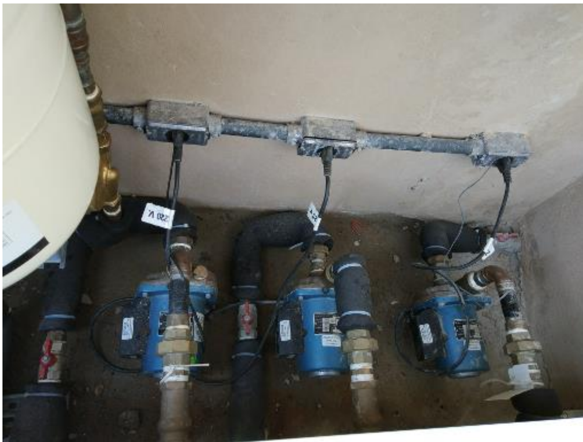
Figura 18: Bombas de circulação e recirculação SAS. Fonte: Acervo próprio.
